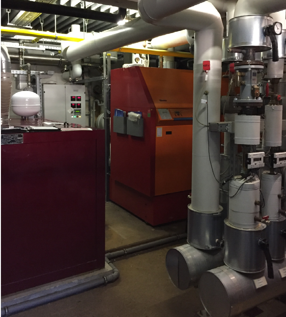
Abb. 22: BHKW (links) und Gaskessel in der Heizzentrale des Bürgerhauses im Stadtteil Hochberg
