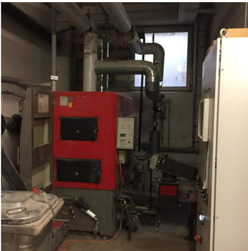
Abb. 24: Hackschnitzelkessel Technische Dienste
