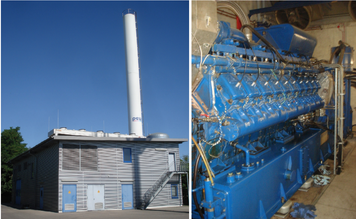
Abb. 17: Heizzentrale PEW und darin verbautes BHKW
