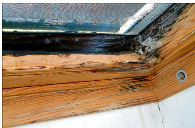
Wer zu wenig lüftet, riskiert Schimmelbildung am Gebäude
