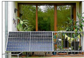
Solaranlage am Balkon speist über Stecker in Wohnungsstromnetz ein Foto: Energieagentur Kreis Ludwigsburg LEA e.V.
